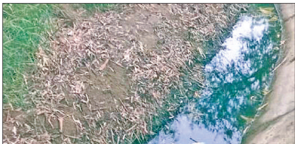
चोपटा । रामपुर माइनर में अत्यधिक मिट्टी, कचरा ।
